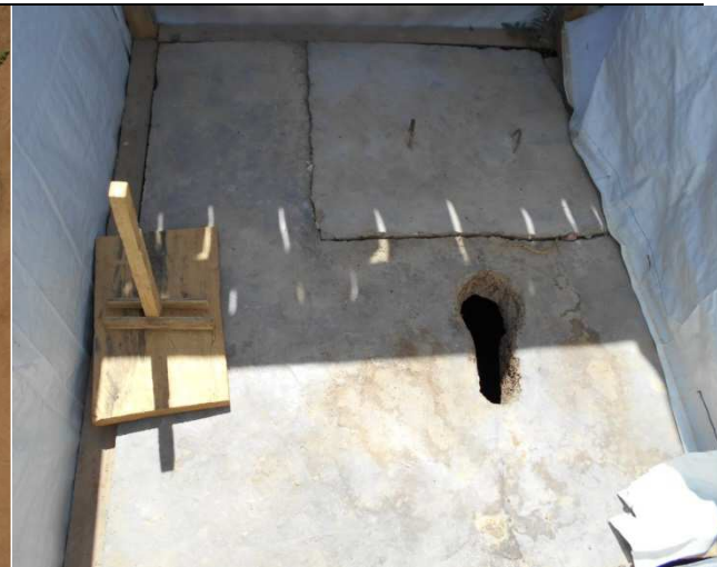
Dalle avec problème de design
