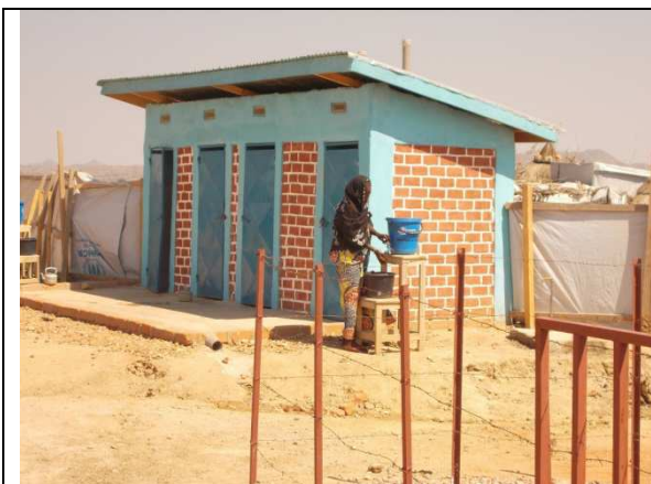
Bloc latrine de 4 cabines centre de santé de IMC
