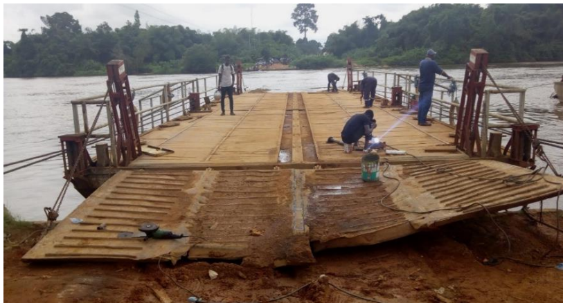
Travaux de réfection du Bac servant à la traversée des convois de rapatriement du Libéria, dans le sud-ouest du pays (Prolo) © UNHCR
